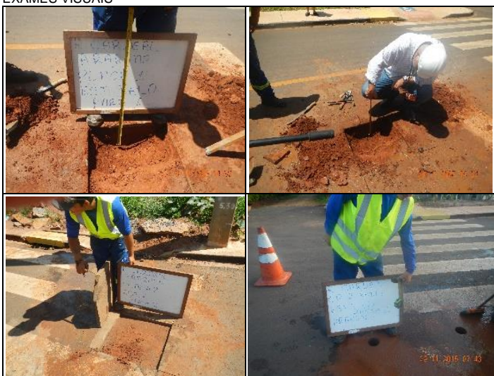
Registros dos ensaios das medições da espessura da camada de base por meio de ensaio destrutivo (abertura de placa de 50 cm x 50 cm) com identificação da espessura por meio visual.
