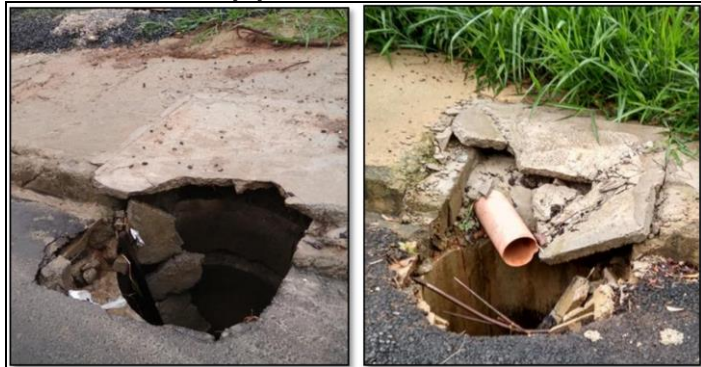
GRELHAS E TAMPAS DANIFICADAS
