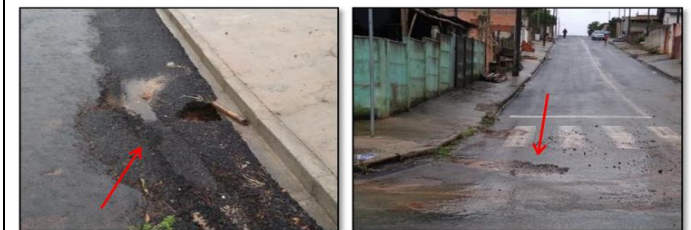
BURACOS E DEPRESSÕES NA AVENIDA JURUTANHÍ
