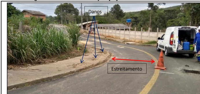
ESTREITAMENTO DA RUA NO TRECHO EM CURVA / DANOS CAUSADOS (EM AZUL) DECORRENTES DO TRÁFEGO DE VEÍCULOS SOBRE A CALÇADA.
