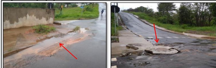
BURACOS E DEPRESSÕES NA AVENIDA JURUTANHÍ
