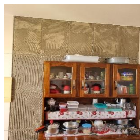
Foto 27: Parede de cozinha de casa em Cornélio Procópio sem azulejos.
