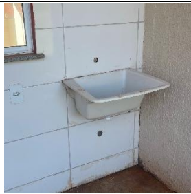
Foto 57: Tanque de lavanderia em residência vazia sem torneira e sifão em Cornélio Procópio.
