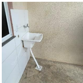
Foto 59: Lavanderia em casa desocupada com conexão inadequada de esgoto em Jaguariaíva.
