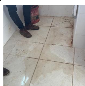
Foto 30: Caimento inadequado de água no piso do boxe de banheiro em Arapongas.
