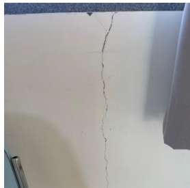
Foto 18: Parede do salão de festas em Cornélio Procópio com fissura.
