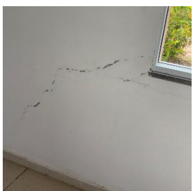
Foto 19: Fissura em parede do salão de festas em Jaguariaíva.
