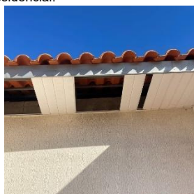
Foto 22: Forro de residência danificado em Cornélio Procópio.
