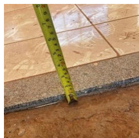
Foto 1: Desnível em entrada de residência em Cornélio Procópio.
