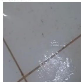
Foto 32: Alagamento em cozinha de residência em Cornélio Procópio.
