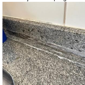
Foto 29: Pedra de bancada da pia descolando da parede em Cornélio Procópio.
