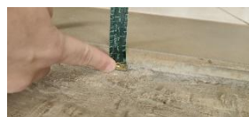
Foto 3: Desnível em entrada de sala da área comum em Prudentópolis.
