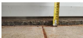
Foto 4: Desnível em soleira de porta da guarita em Foz do Iguaçu.
