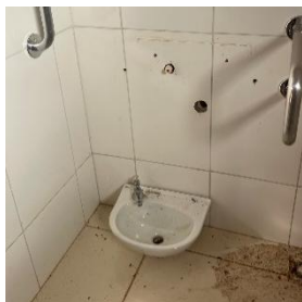
Foto 58: Pia de banheiro desmontada em residência desocupada em Cornélio Procópio.
