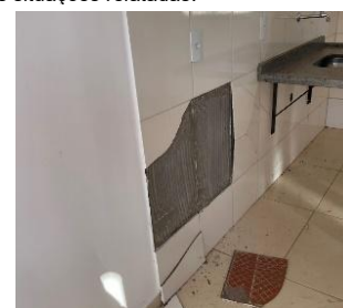
Foto 26: Azulejos soltos em residência em Cornélio Procópio.
