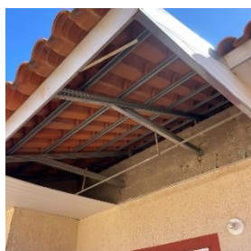
Foto 24: Forro de residência danificado em Cornélio Procópio.
