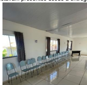
Foto 21: Forro do salão de festas danificado em Cornélio Procópio.
