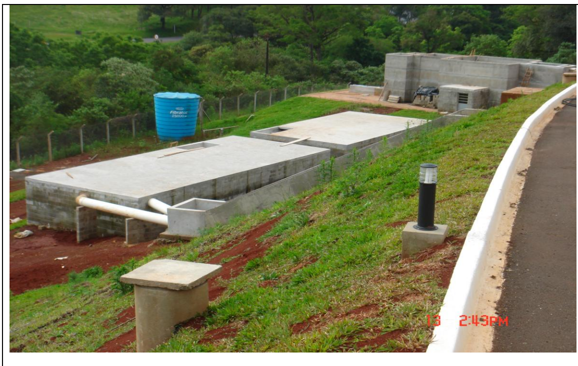
Foto 13 – Caixa de concreto para depósito de esgoto hospitalar em razão da ausência de Estação de Tratamento de Efluentes, não prevista em projeto para o Hospital de Francisco Beltrão. Diariamente, a Prefeitura recolhe o esgoto e encaminha para a estação de tratamento municipal – outubro de 2008.
